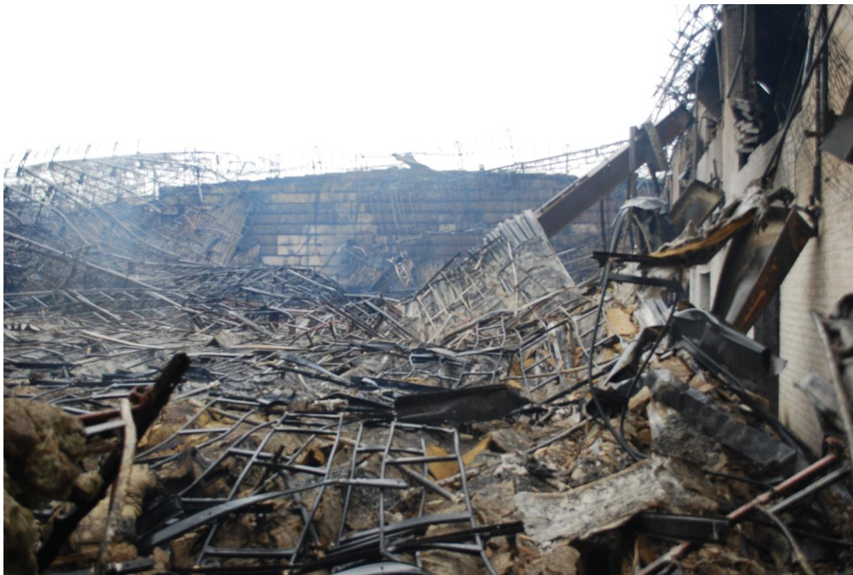
Bild 3. Takkonstruktionen inne i hallen efter branden.
